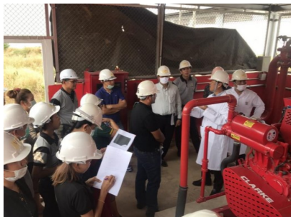
กิจกรรมการตรวจสอบระบบดับเพลิง (โรงงานผลิตอาหารสัตว์พุกา:ธุรกิจในการประทศลาว)
